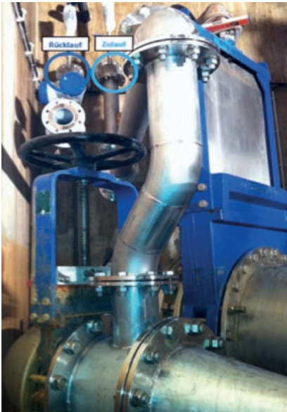
Abb. 5 Blick in das SBW 6 mit Molchschleuse, Zu- und Rücklauf zur Wärmepumpe des Lessing-gymnasiums Hoyerswerda
